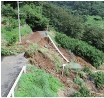
市道7号線の崩落箇所(南矢名)
