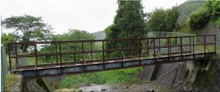
塗装の劣化が目立つ人道橋
