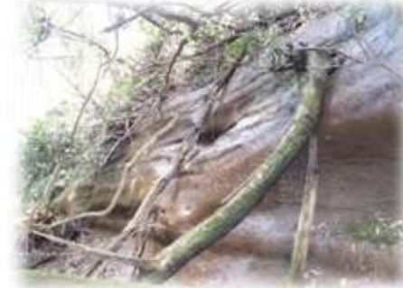
写真：法面の浸食状況
