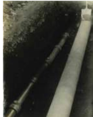
水道管理設写真 左側：鉄管 右側：陶管
