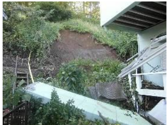
【人家への被害】
