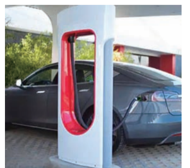
高出力の急速充電設備
