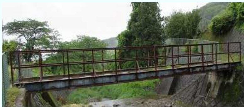
避難経路での利用が検討され、塗装の劣化が目立つ人道橋
