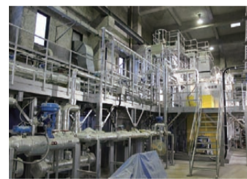
B-DASH事業により設置された汚泥乾燥機
