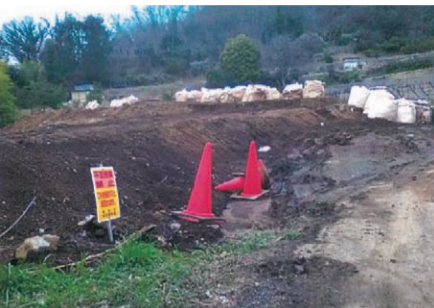
盛り土による土砂災害への対策を(曽屋地区の盛り土の様子)
