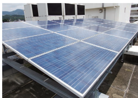
再生可能エネルギーへの転換を(市役所西庁舎屋上のソーラーパネル)
