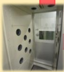
【エアシャワー室】
