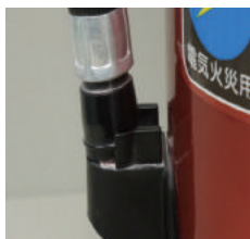
× 消火薬剤の漏れ
