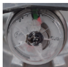
× 指示圧力計の損傷
