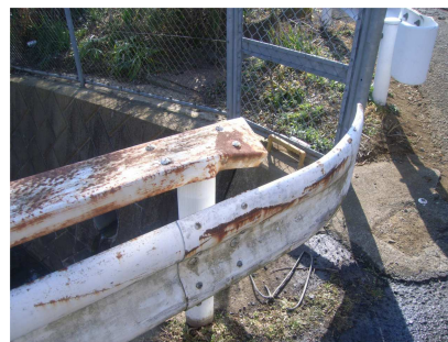
防護柵:変形・欠損(対策区分 M)
