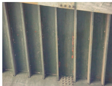
床版:防食機能の劣化、腐食(対策区分 B)
