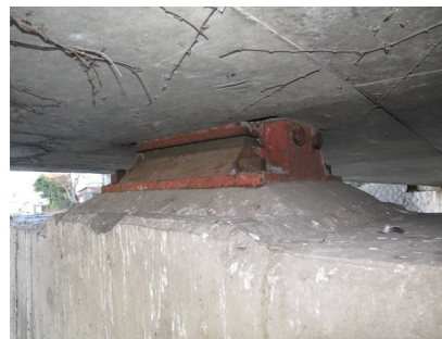
支承:防食機能の劣化、腐食(対策区分 C)
