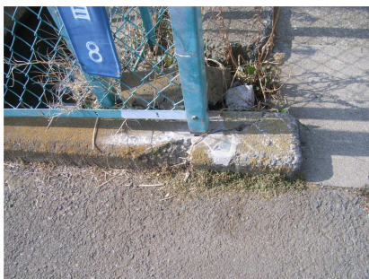
地覆:変形・欠損(対策区分 M)
