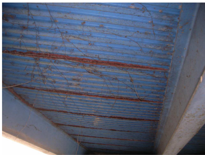
床版:防食機能の劣化、腐食(対策区分 C)
