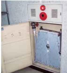
人命確保に必要な消防設備の設置を(写真は屋内消火栓)
