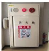
屋内消火栓設備
