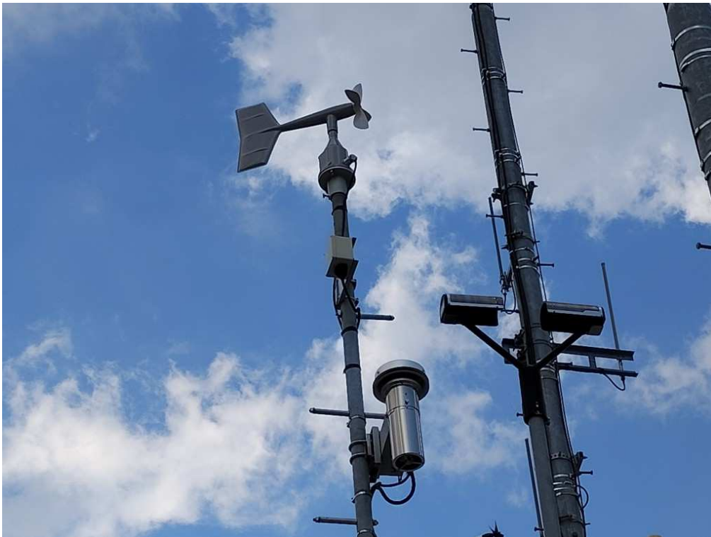
【気象観測装置（消防本部屋上）】
