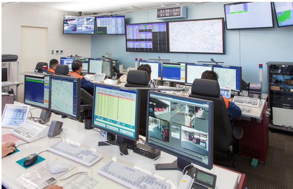
平成26年3月1日に更新した通信指令システム
