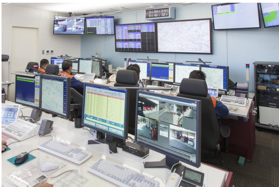
平成26年3月1日に更新した通信指令システム
