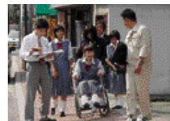
歩道の傾きが通行の支障に
