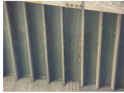
床版: 防食機能の劣化、腐食(対策区分 B)
