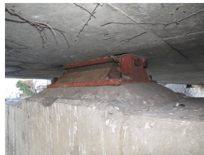
支承: 防食機能の劣化、腐食(対策区分 C)
