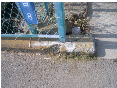
地覆: 変形・欠損(対策区分 M)
