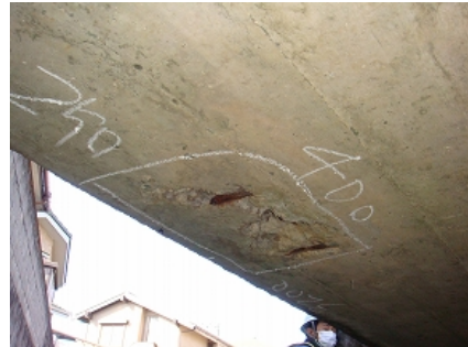
床版: はく離・鉄筋露出(対策区分 B)
