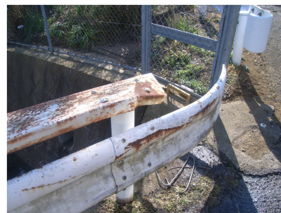
防護柵: 変形・欠損(対策区分 M)
