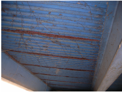
床版: 防食機能の劣化、腐食(対策区分 C)
