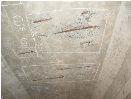
床版: はく離・鉄筋露出(対策区分 C)
