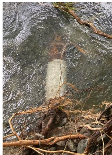
破壊された鉄管
