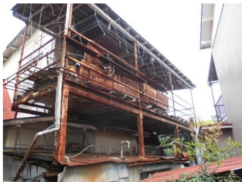
< 腐食したバルコニー >
