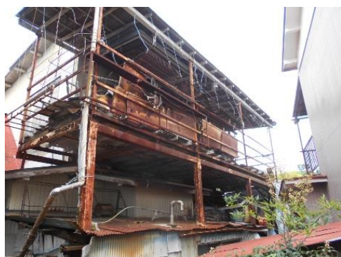
< 腐食したバルコニー >
