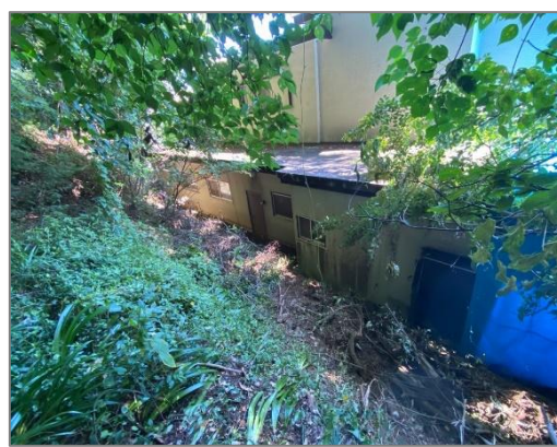
令和6年台風第10号による被災箇所
