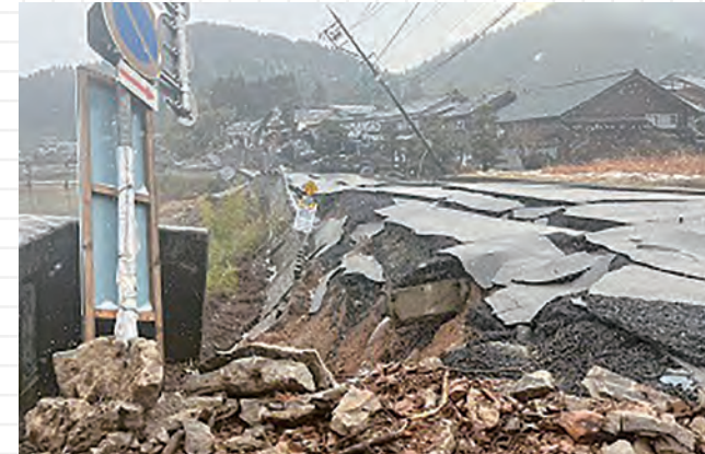
道路が崩壊した輪島市
