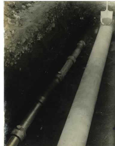
水道管理設写真 左側：鉄管 右側：陶管
