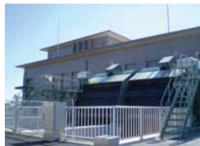
※写真は鶴巻地区の浸水対策として整備した大根川ポンプ場(平成24年11月しゅん工)
